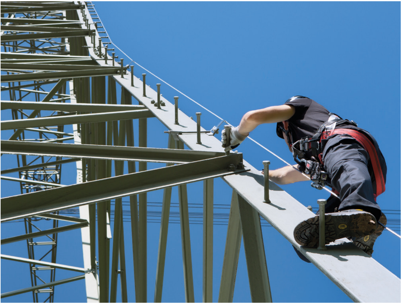
Seil-Steigschutzsystem SSE im Einsatz an einem Hochspannungsmasten
